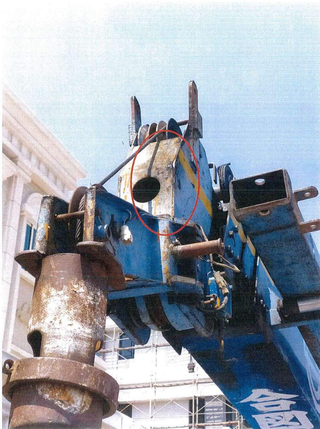
109.04.15 69kV 興龍~林邊線#46~#47 S-T相(二-三號線)事故照片
